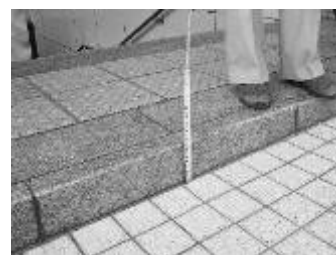
階段出入口部の段差を改善してほしい
