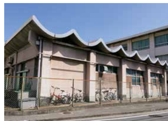
▲老朽化している給食室 (播磨小学校)
