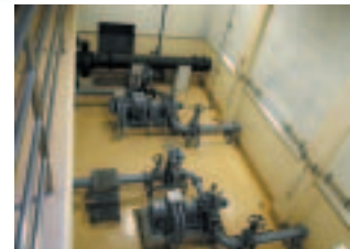
⑧配水ポンプ 配水池に蓄えた飲料水に圧力をかけて各家庭へ送り出す設備です。
