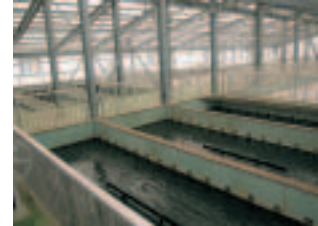
④フロック形成池 薬品と原水をゆっくりかき混ぜて濁りなどの固まり(フロック)を作る設備です。
