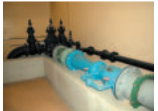
応援用連絡管 災害時に近隣市より応援給水を受けることができます。
