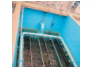
⑥ろ過池 濁りなどを取り除いた水をさらに砂の層を通してろ過し、汚れを完全に除去する設備です。
