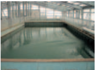
⑤沈でん池 濁りなどの固まり(フロック)を沈でんさせて取り除く設備です。
