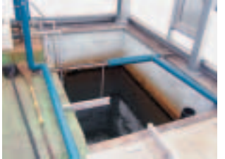
②着水井 水の流れをゆっくりにして、原水の量をはかる設備です。
