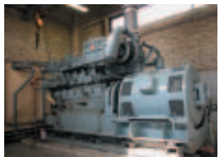
自家発電装置 停電時でもポンプなどを止めることなく水を送ります。
