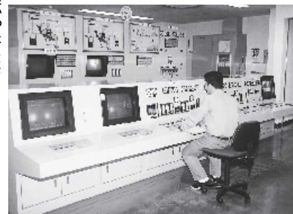
ごみ焼却施設制御盤を操作中
