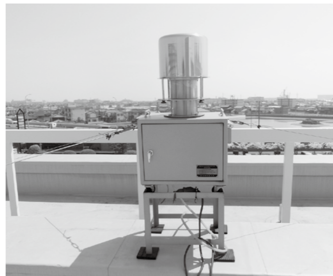
▲PM2.5測定装置（庁舎屋上）
