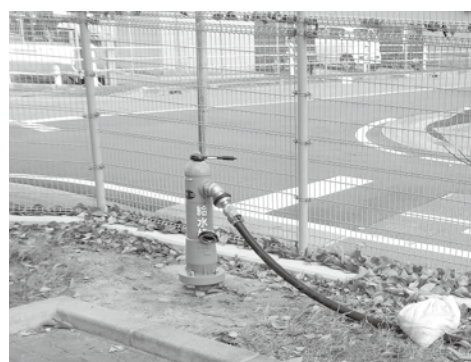
整備された応急給水栓
