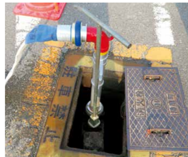
▲火災に備えて設置している消火栓
