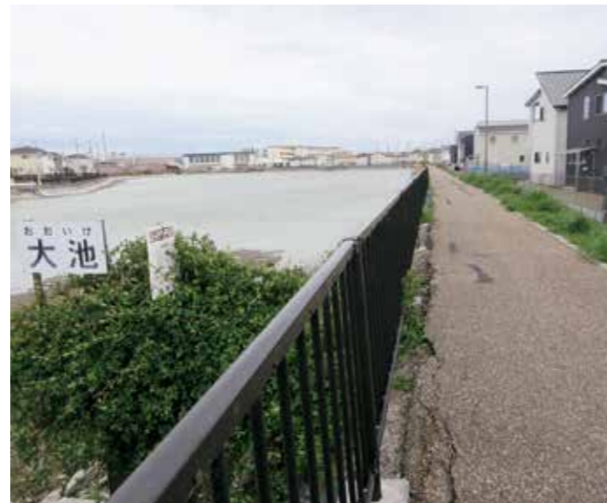
▲遊歩道に亀裂が見られる大池堤体
