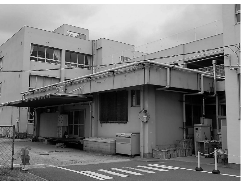
▲耐震化が待たれる給食棟と渡り廊下
