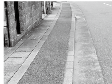
▲勾配が連続する歩道
