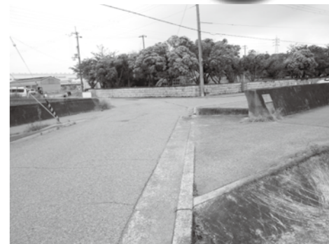
▲途切れている堤防（古宮漁港）
