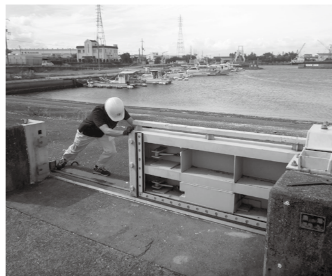
▲水害から地域を守る防潮ゲート（阿閉漁港）
