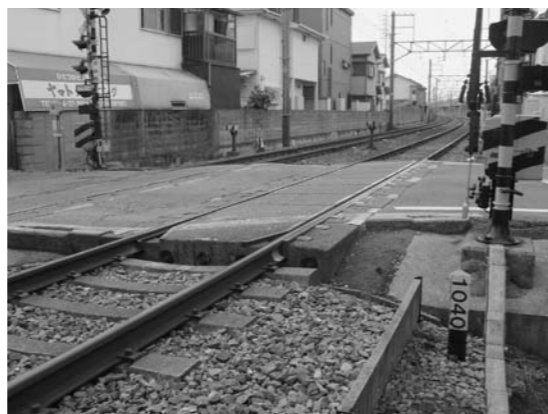
▲凹凸があり、危険な踏切
