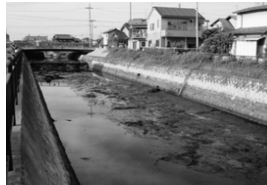
▲ヘドロの堆積によって悪臭が発生する水田川
