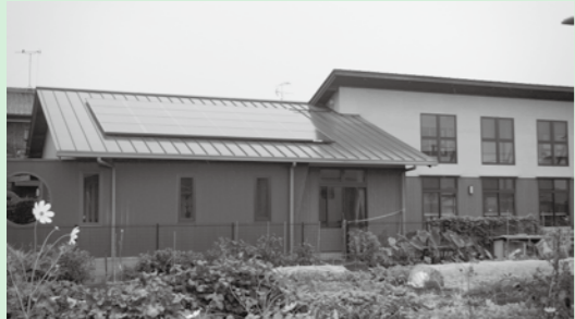
▲南部子育て支援センターに設置している太陽光パネル
